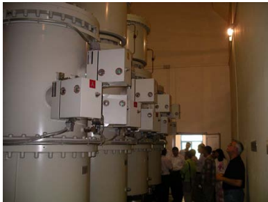
Подстанция 400 кВ TEIAS (вверху) и газовая шина подстанции закрытого типа (внизу)
